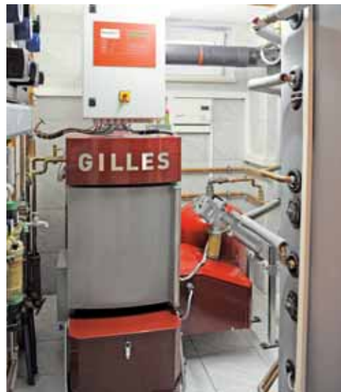
Im Heizraum wurden Pelletskessel und dergleichen auf engstem Raum untergebracht.
