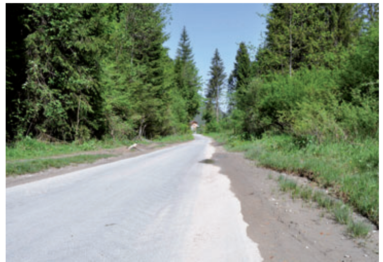
Die Verbindung von Pflach nach Lechaschau wird immer wieder überflutet.
