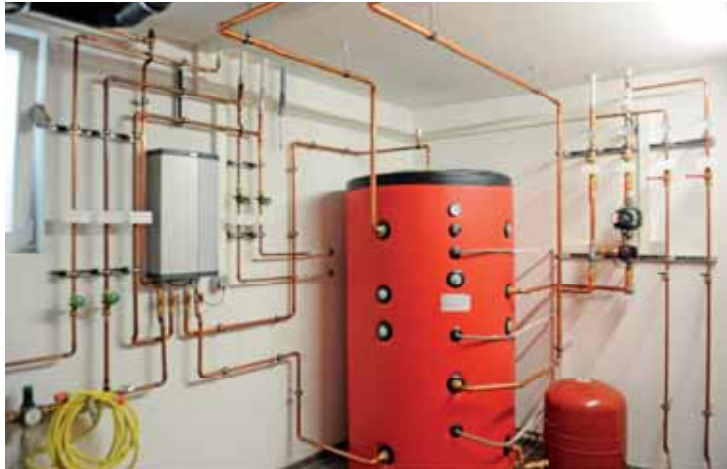
Vorbildliche Installation im Technikraum.
