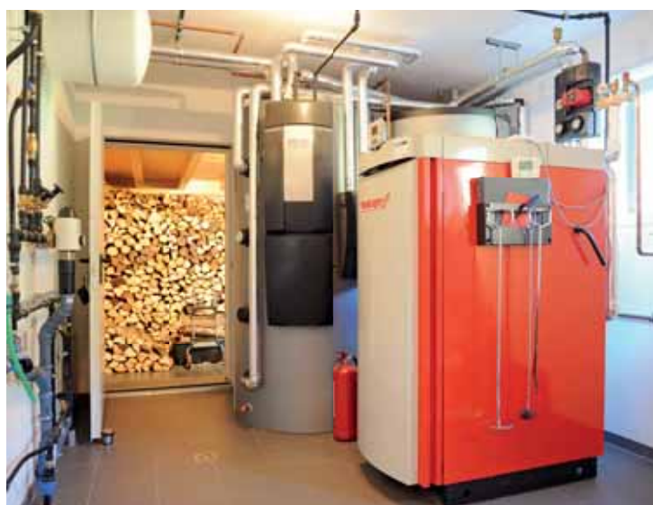
Geheizt wird mit Stückgut und einer 17 Quadratmeter großen Solaranlage.
