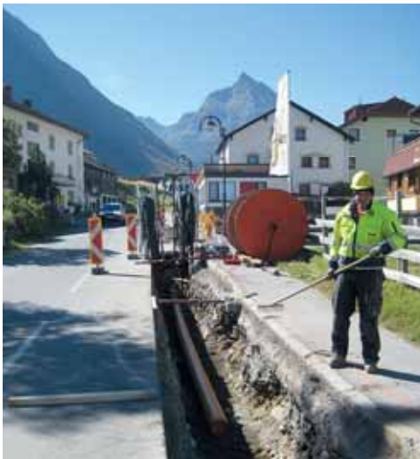
Die Gemeinde Galtür wurde im Jahr 2015 an die Erdgasversorgung angeschlossen.
