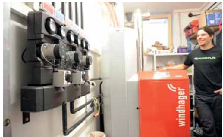
Eine Pellettheizung sorgt für kuschelige Wärme im ganzen Haus.
