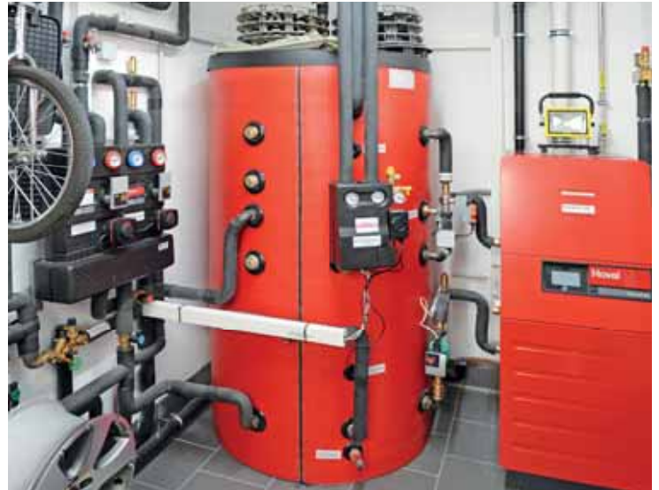
Im Technikraum ist alles funktionell angeordnet.
