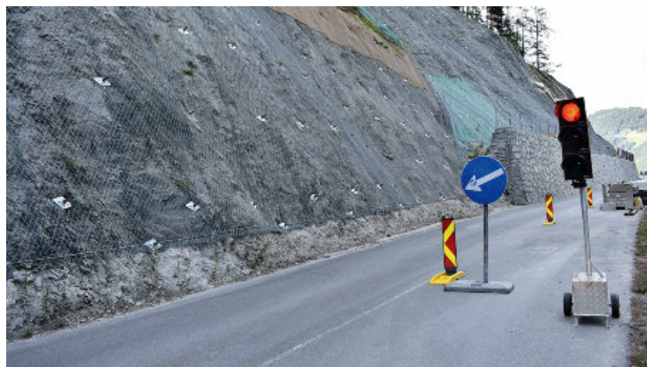
Die Straße nach Ladis ist nach dem Felssturz einspurig befahrbar und durch eine Ampel geregelt. Die Zufahrt nach Fiss und Serfaus ist ohne Einschränkungen befahrbar.
