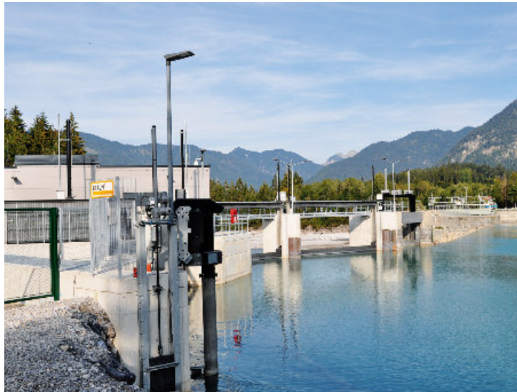
Das neue Höfener Kraftwerk zeigt deutlich, dass ein Nebeneinander von Natur und Technik absolut möglich ist.
