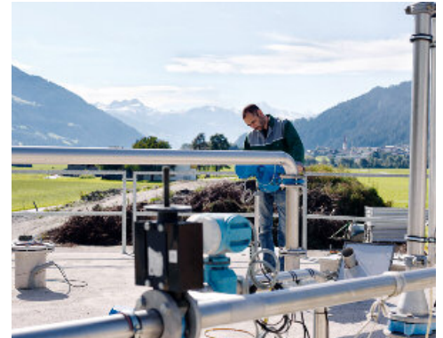
Das im Zillertal auf Erdgasqualität aufbereitete Biogas wird als erneuerbare Alternative zu Erdgas und als Treibstoff für Erdgasfahrzeuge verwendet.
