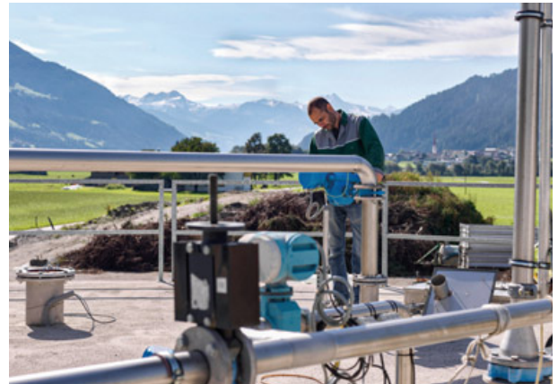
Das im Zillertal auf Erdgasqualität aufbereitete Biogas wird als erneuerbare Alternative zu Erdgas und als Treibstoff für Erdgasfahrzeuge verwendet.
