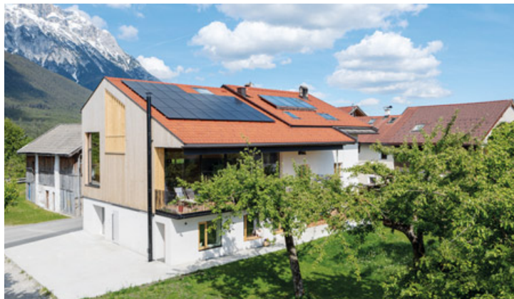
Mit der Photovoltaikanlage zum Haus der Zukunft.
