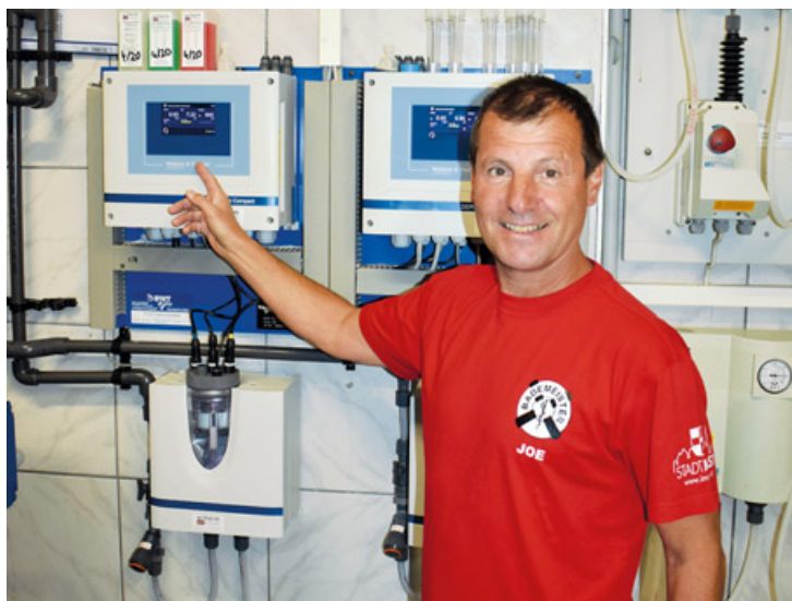
Die Arbeit als Bademeister bietet viel Abwechslung. Die Haustechnik, die in Imst über die städtische Fernwärme gespeist wird, muss laufend gewartet werden.
