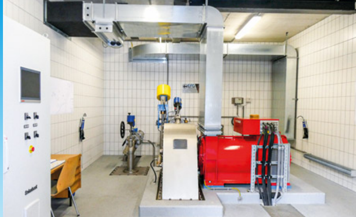
Der Generator des Pfunds Kraftwerks produziert zwischen 1,3 und 1,5 GWh sauberen Strom pro Jahr.
