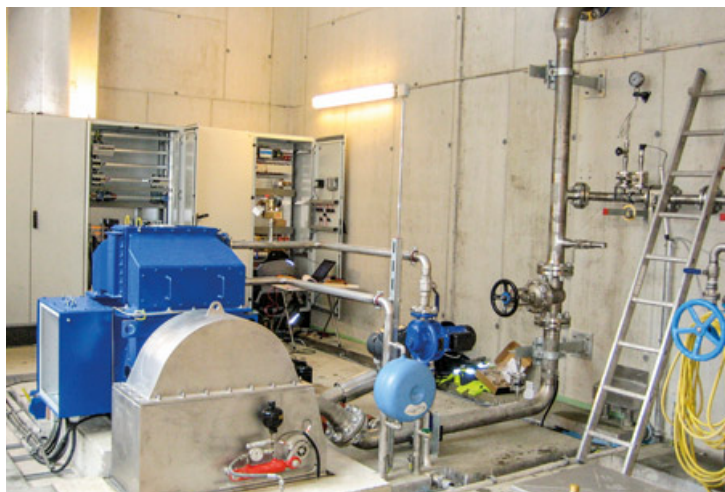
Mit diesem Trinkwasserkraftwerk können alle kommunalen Bauten von Bach mit Energie und Wärme versorgt werden.
