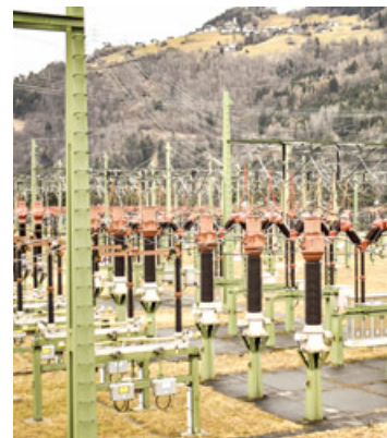
Das Umspannwerk der Verbundgesellschaft in Ötztal-Bahnhof soll erweitert werden. Die Gemeinde will damit verbundene Belastungen eindämmen.
