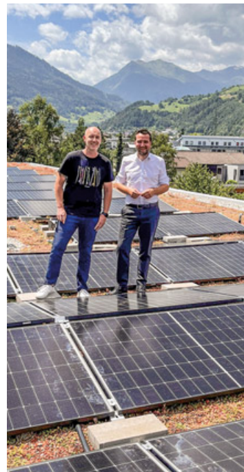
In Zams wurden auf mehreren Dächern öffentlicher Gebäude Photovoltaikanlagen errichtet. Fotos: Gemeinde Zams
