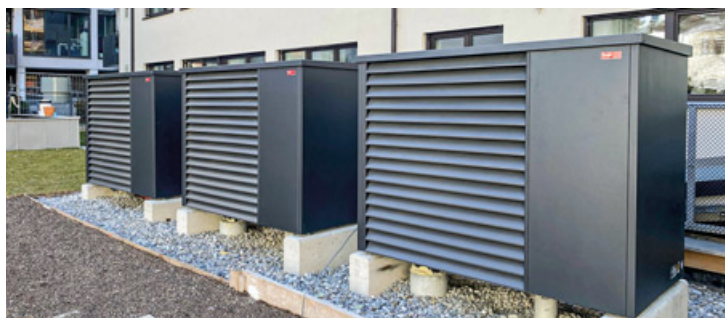
Spitzenreiterin unter den erneuerbaren Heizsystemen – Wärmepumpen arbeiten effizient und nutzen die kostenlose Umgebungswärme. Foto: Energieagentur Tirol
