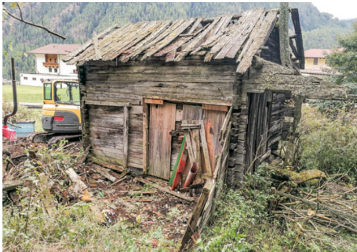
Der Zustand der Mühle war vor zwei Jahren noch mehr als besorgniserregend, die Hütte einsturzgefährdet.
