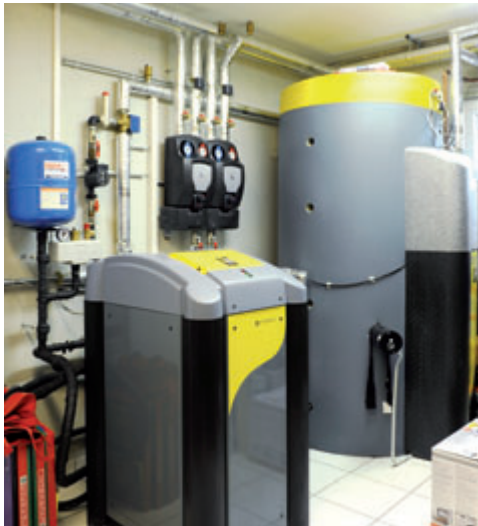
Im Vordergrund: die Wärmepumpe, rechts: der Boiler, der an der rechten Seite über einen Wärmetauscher über eine eigene Trinkwassererwärmung verfügt. Notfalls kann mit einer Heizpatrone gearbeitet werden.
