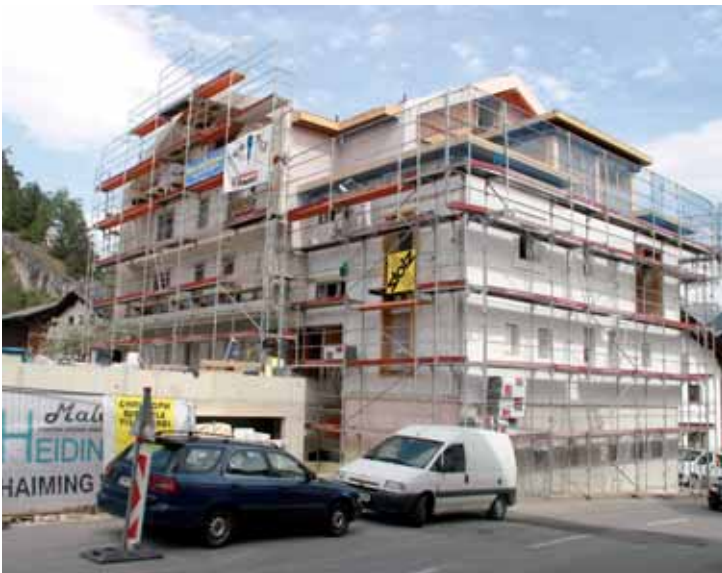
Schon bald sind Gerüst und Kran verschwunden und die Bauarbeiten gehen in die Endphase.
