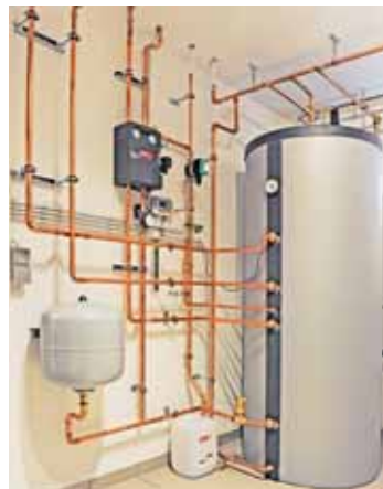
Technikraum mit Boiler, der auch von einer Solaranlage gespeist wird.
